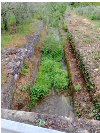
27.1 Pietrastornina: Vallone Paradisi, parte degli argini con muratura in pietra
