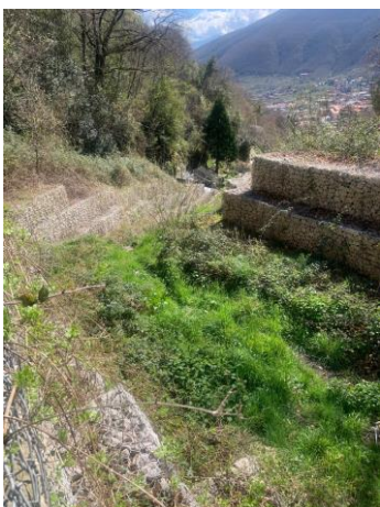
16.2 Monteforte Irpino: Vallone dei Monaci presenza di tratto in gabbionate
